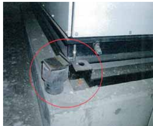
空調機防振装置はずれ
