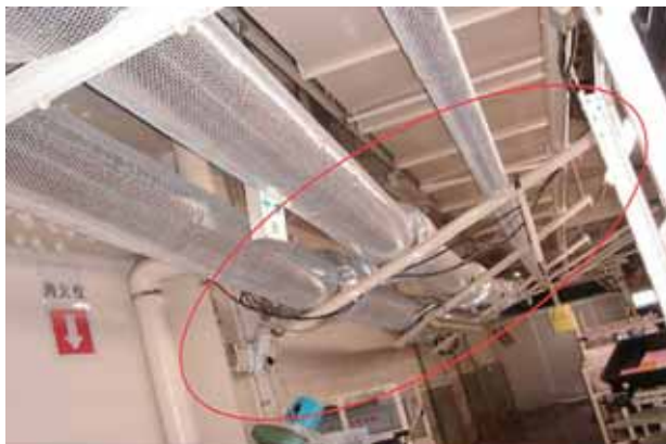
冷却水配管支持金物脱落
