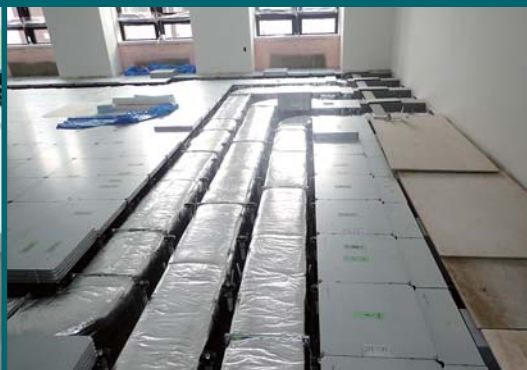
■ 床吹出空調のOA内ダクト
