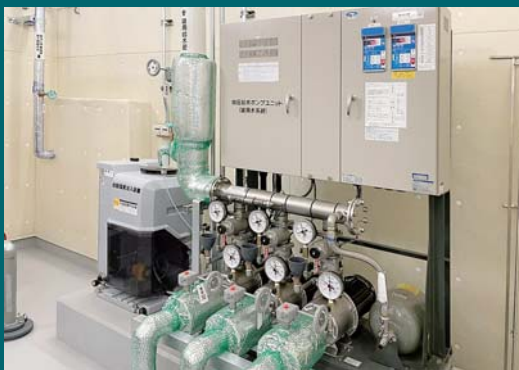
■ 雑用水給水ポンプ廻り
