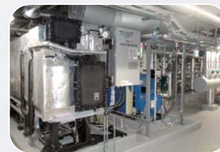
冷温水機真空温水機
