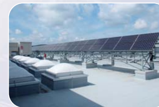
太陽光パネル
