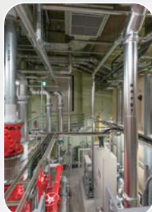
受水槽ポンプ室
