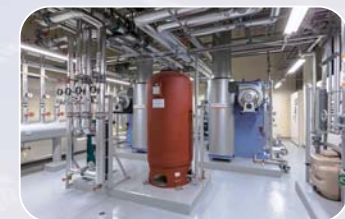
ペレットボイラー室
